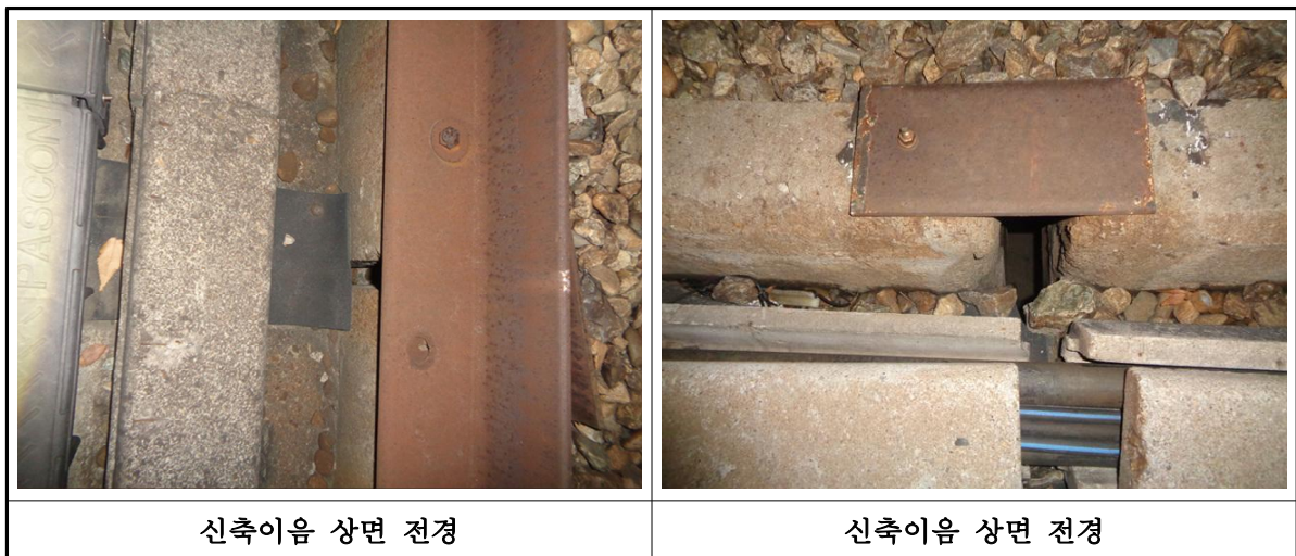
【그림 II-3.3.19】 신축이음 현황 및 조사 전경
